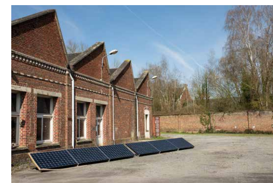
工場の外に設置されたソーラーパネル。ソーラー発電で得た電力を貯める蓄電池として、性能が落ちてきた電動バイクのバッテリーを再利用している。
